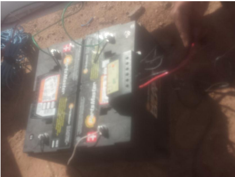
Imagen 5.9: Conexión a un par de baterías para almacenar la energía producida por el equipo.
