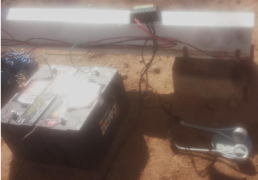
Imagen 5.10: Circuito completo de la unidad de potencia en conexión con las baterías y las resistencias.
