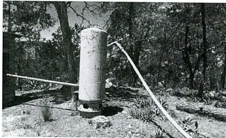
Ilustración 5.- enfriador de aire.
