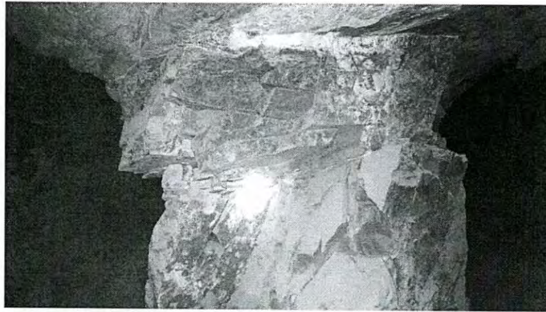
Ilustración 21.- Pilar deteriorado con fractura.
