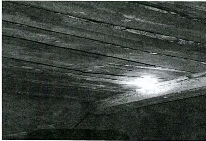
Ilustración 18.- Desgaste y despostillamiento de una madera por sobre carga.
