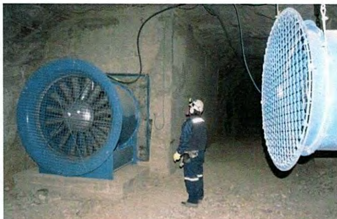
Figura 28. Ventiladores en interior mina.
