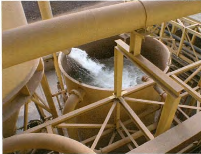
FIGURA 49. Solución rica proveniente del clarificador.
