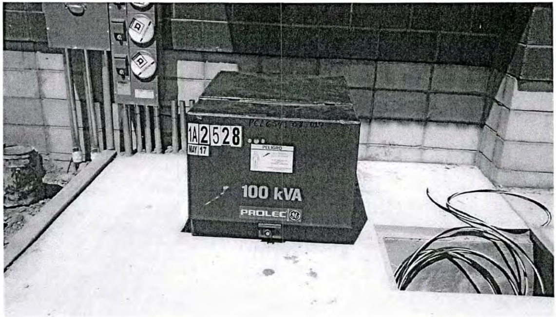
Figura A.31 Transformador de 100 kVA
