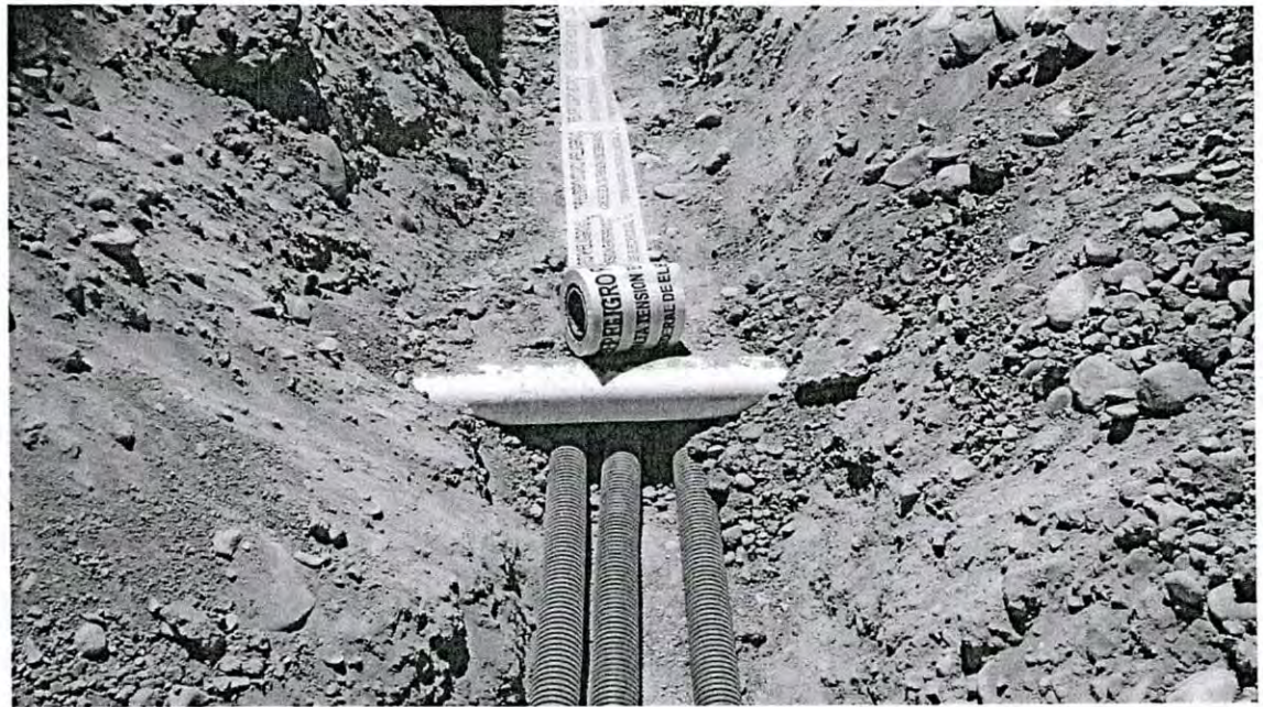
Figura A.28 Cinta de Seguridad sobre el Sembrado Eléctrico
