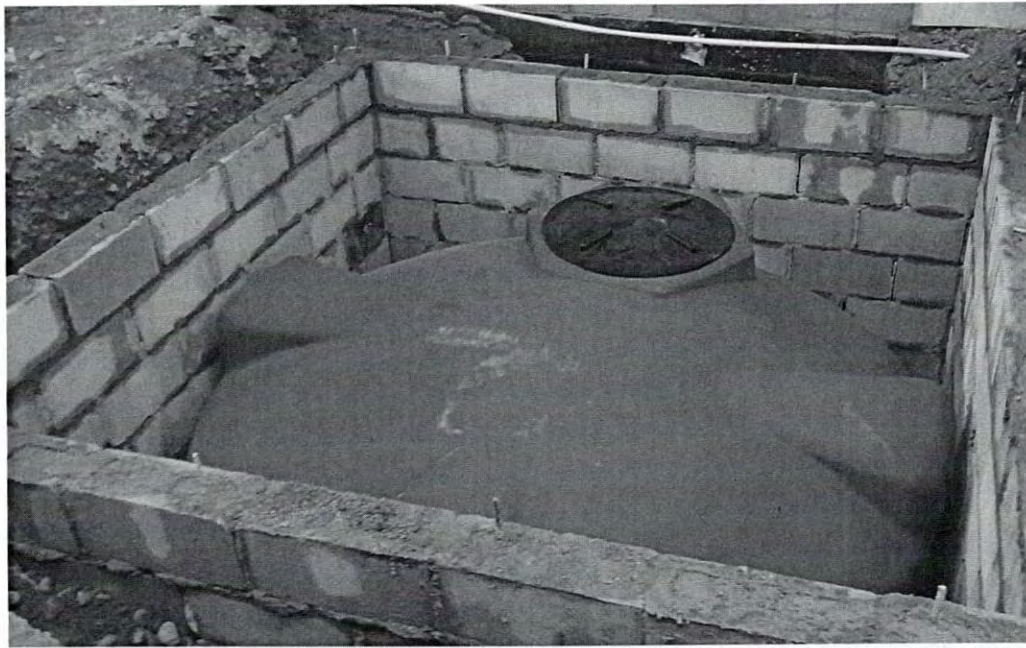
Figura 4.1 Cisterna para desechos tóxicos
