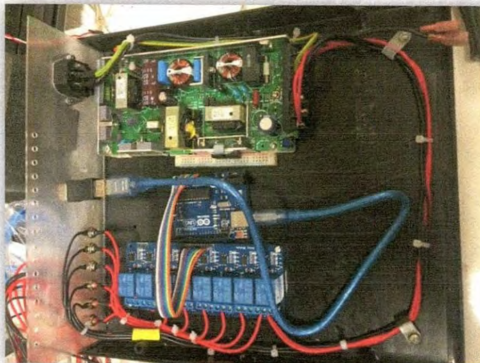
Figura 38. Unidad de Control con fuente de alimentación, arduino y banco de relevadores.
