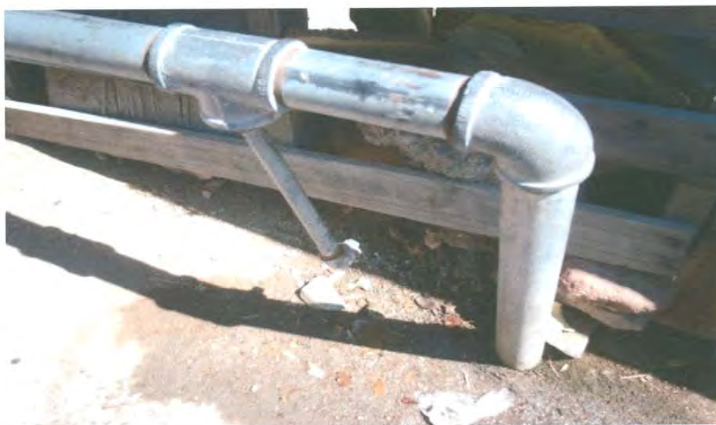
Foto 4. Tubería de agua potable
