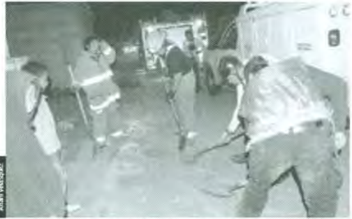
Personal de emergencias tapó la zanja después de que rescataron al menor la tarde noche del domingo.
