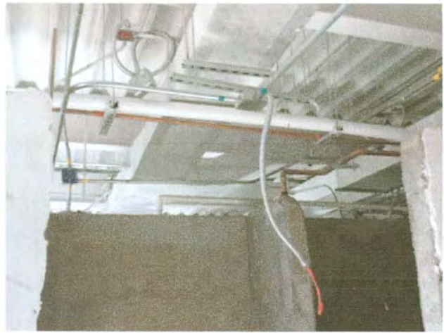
CABLEADO DE CONTROL DE INCENDIO SECCION 002
