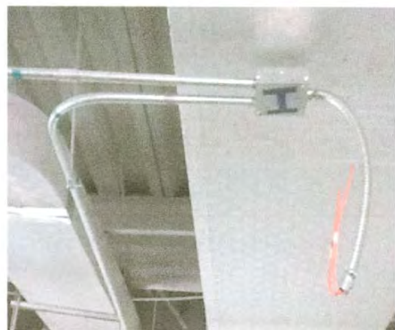
CABLEADO DE CONTROL DE INCENDIO SECCION 005
