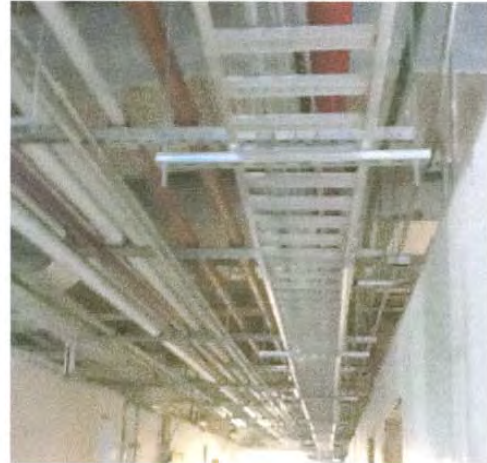
CABLEADO DE VOZ-DATOS Y CONTROL DE ACCESO SECCION 005
