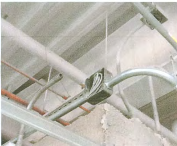
CABLEADO DE VOZ Y DATOS SECCION 005
