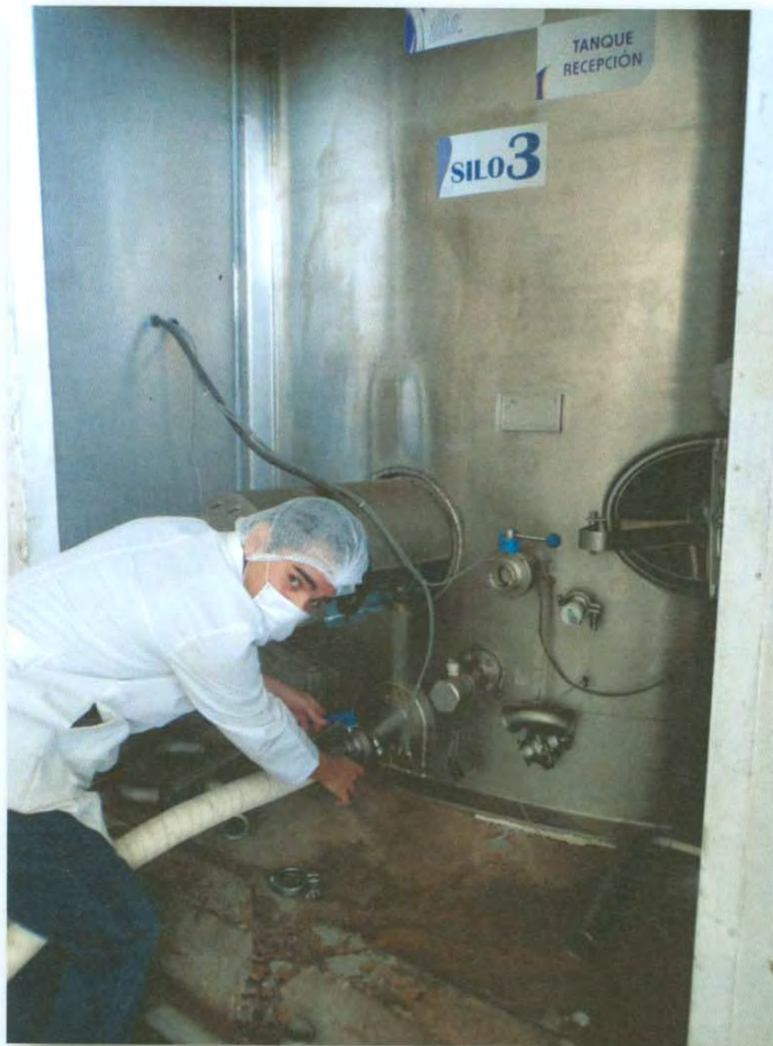
Figura 29. Conexión de manguera en silo de recepción de leche
