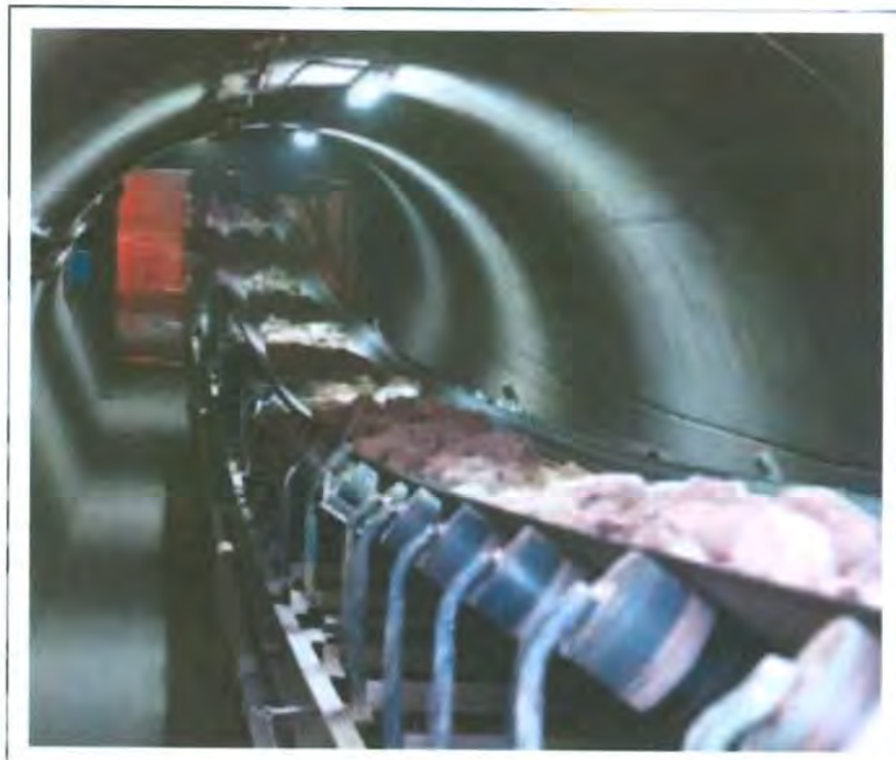
Figura 1. Banda transportadora mina María, conectada de a la quebradora principal.
