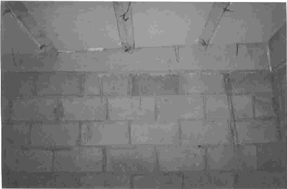
Foto # 8a. Concreto en piñas.
