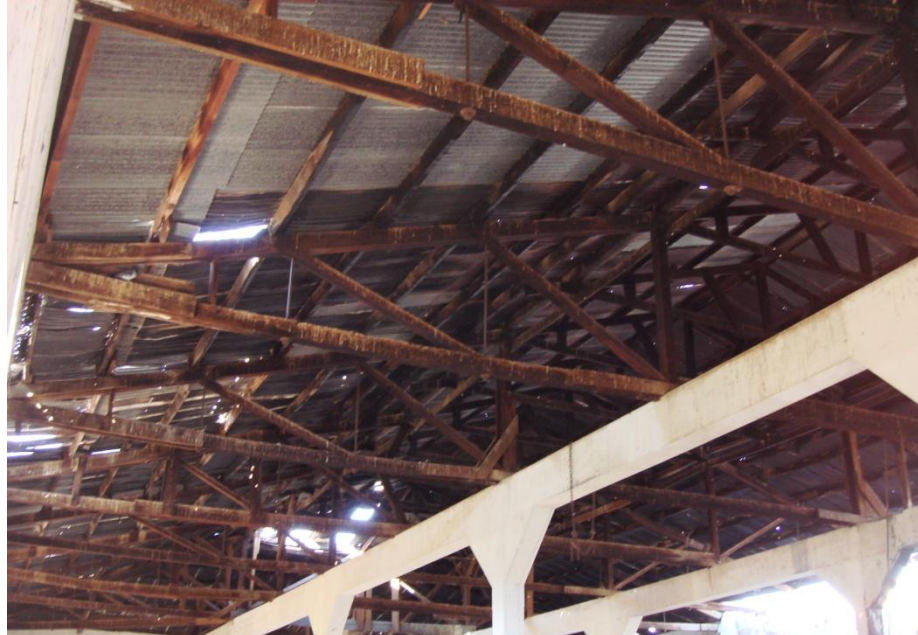
IMAGEN 40: Cubierta en mal estado edificio del antiguo rastro. Fotografía: Juan Luis Fernández V.
