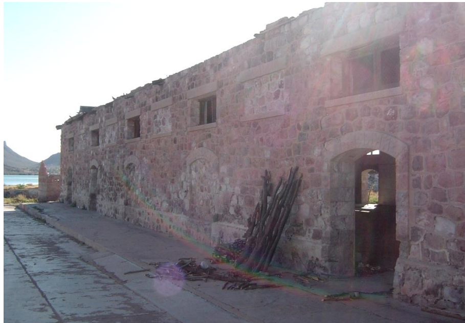
IMAGEN 34: Estado actual del edificio del antiguo rastro vista oriente. Fotografía: Juan Luis Fernández V.
