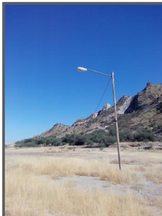
Fotografía 12. Vista Red Eléctrica. Fuente: Archivo Propio
