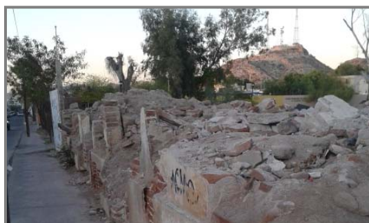
Imagen 1-5. Escombros dentro del polígono uno. Fuente: Espinoza Montaña (2016)
