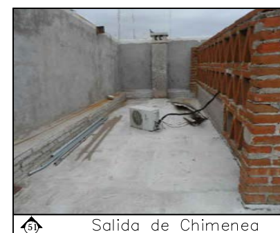
51 Salida de Chimenea
