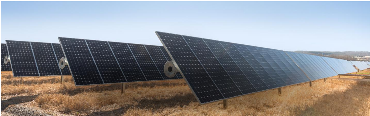
Imagen 2.2 Parque de paneles solares. Fuente: Google.
