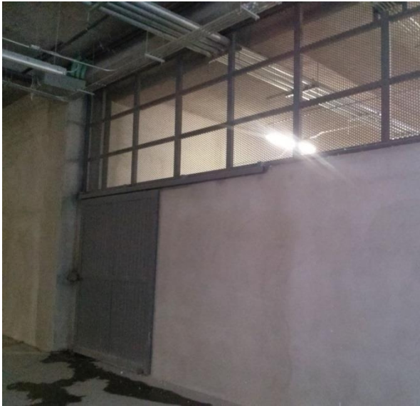
Ilustración 102 Puerta de acero en cuarto de máquinas. Autor: Eva Zavala
