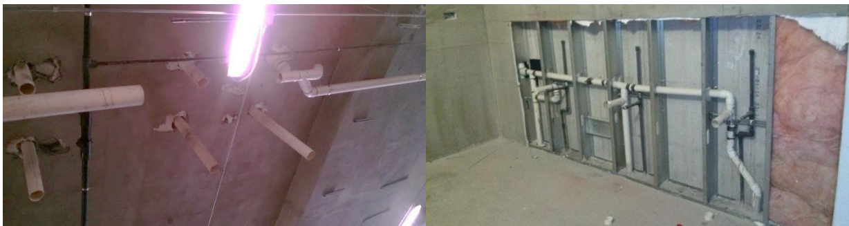
Ilustración 105 Tubería de instalación sanitaria en baños públicos. Autor: Eva Zavala
