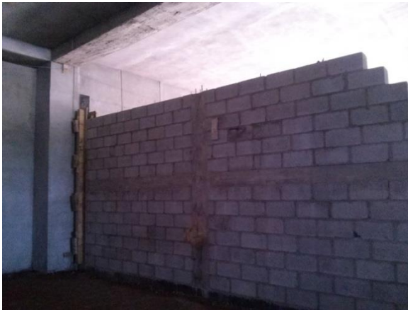
Ilustración 91 Muro de block de concreto en cuarto de máquinas. Autor: Eva Zavala
