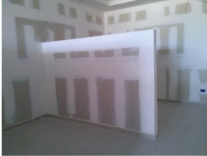
Ilustración 93 Muros de tablaroca a 3m y 1.80 m en el área jurídica. Autor: Eva Zavala
