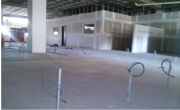
Ilustración 104 Instalación eléctrica para mamparas. Autor: Eva Zavala
