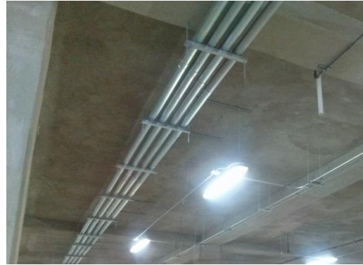
Ilustración 105 Tubería de instalación eléctrica. Autor: Eva Zavala
