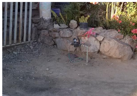
Ilustración 41. Acometida de agua potable. Fuente propia
