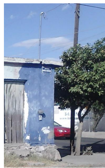
Ilustración 45. Acometida eléctrica. Fuente propia
