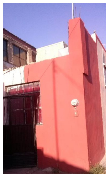
Ilustración 43. Acometida eléctrica. Fuente propia
