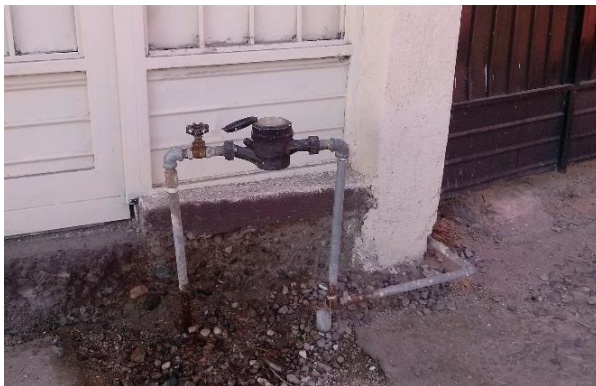
Ilustración 40. Acometida de agua potable. Fuente propia
