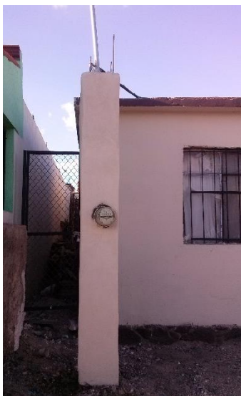
Ilustración 44. Acometida eléctrica. Fuente propia
