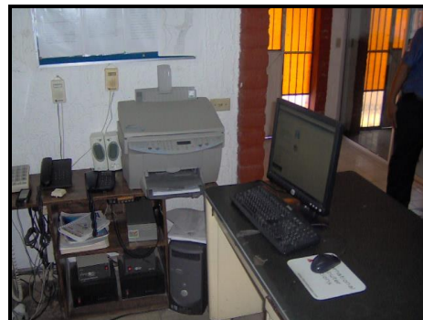
Figura 5. Área de radio y comunicaciones
