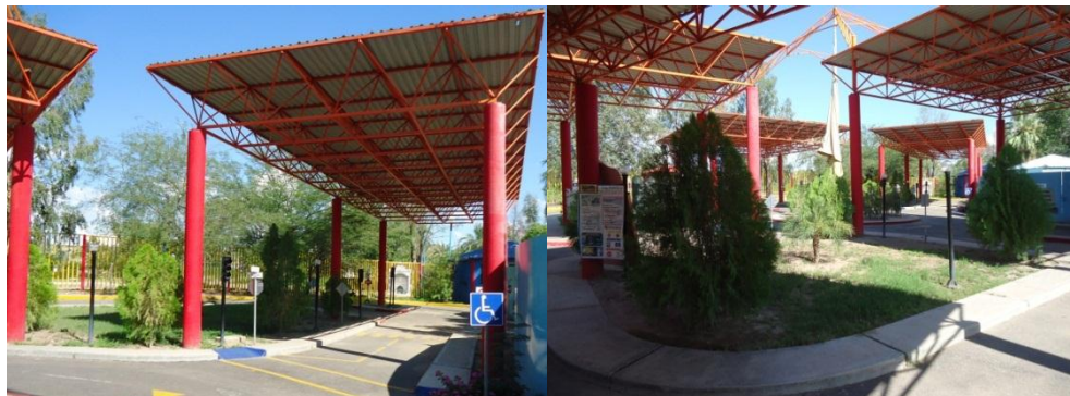
Foto 31. Vistas del sistema estructural. Aquí se alcanzan a notar las columnas, armaduras y láminas empleadas en la construcción de los elementos de sombra. Archivo fotográfico propio 2012
