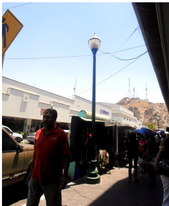
Imagen 90: Cableado eléctrico expuesto. Fuente propia.
