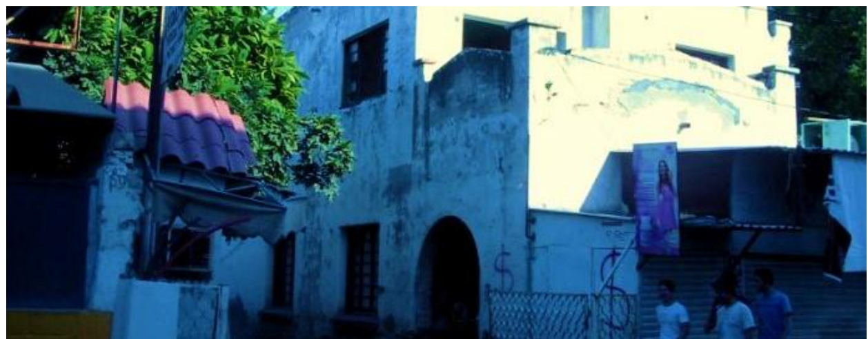
Imagen 77: Casa antigua en muy mal estado con negocio al frente. Fuente: propia.
