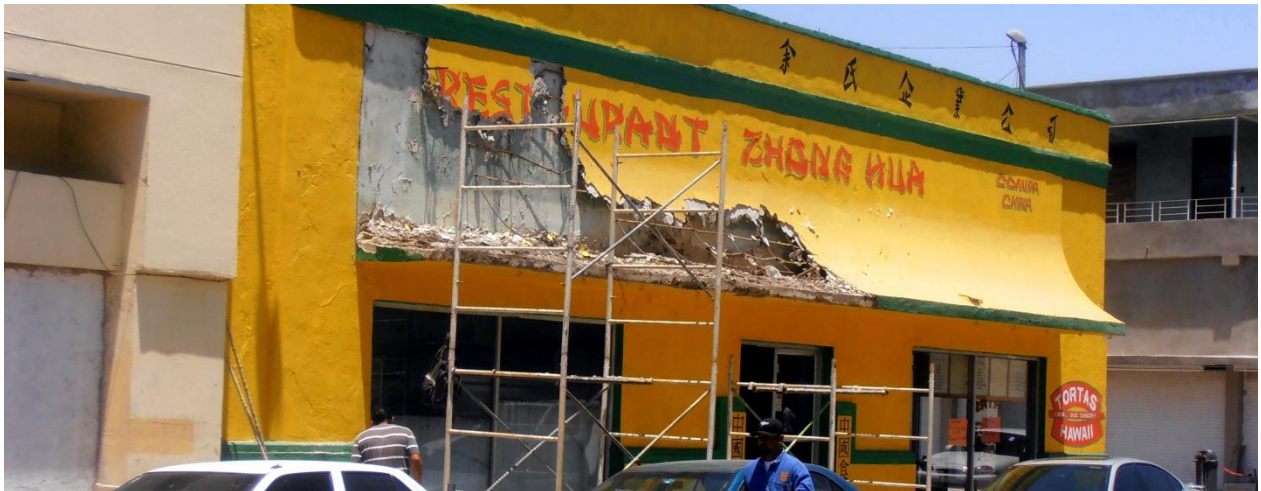
Imagen 93: Destrucción de techumbres para emparejamiento de fachadas. Fuente propia.
