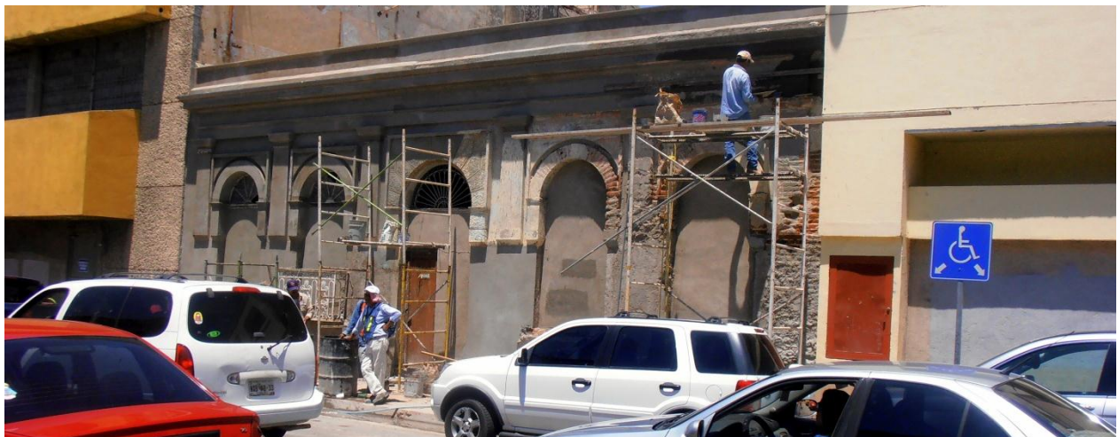
Imagen 94: Recuperación de fachada en antigua vivienda, la cual se pierde por los elementos contiguos a ésta. Fuente: propia.
