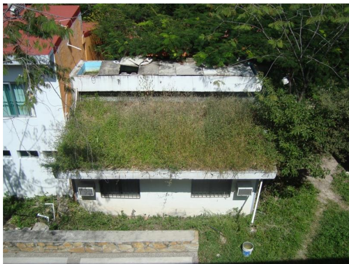
Figura 1. 9 Techo verde extensivo, en una vivienda experimental para la población de escasos recursos, ubicada en terrenos de la Facultad de Arquitectura de la Universidad Autónoma de Chiapas.
