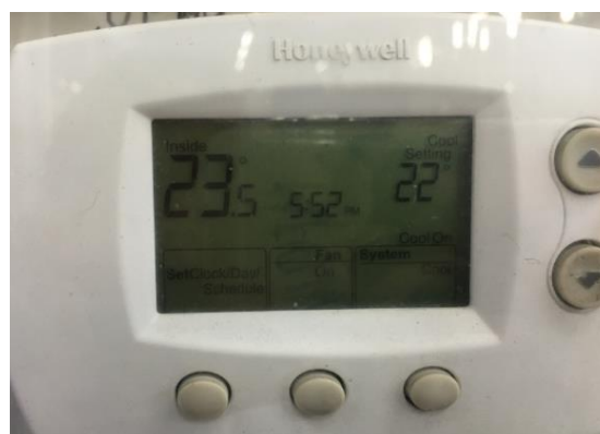
Figura 4.2. Termostato del área de foam
