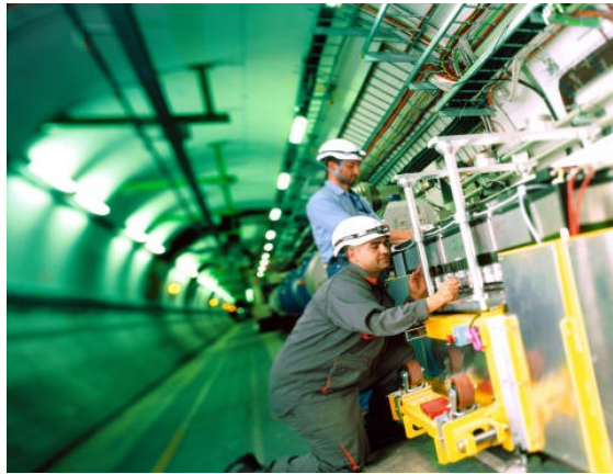
Figura 11. Fotografía en el momento de instalación del ZDC
