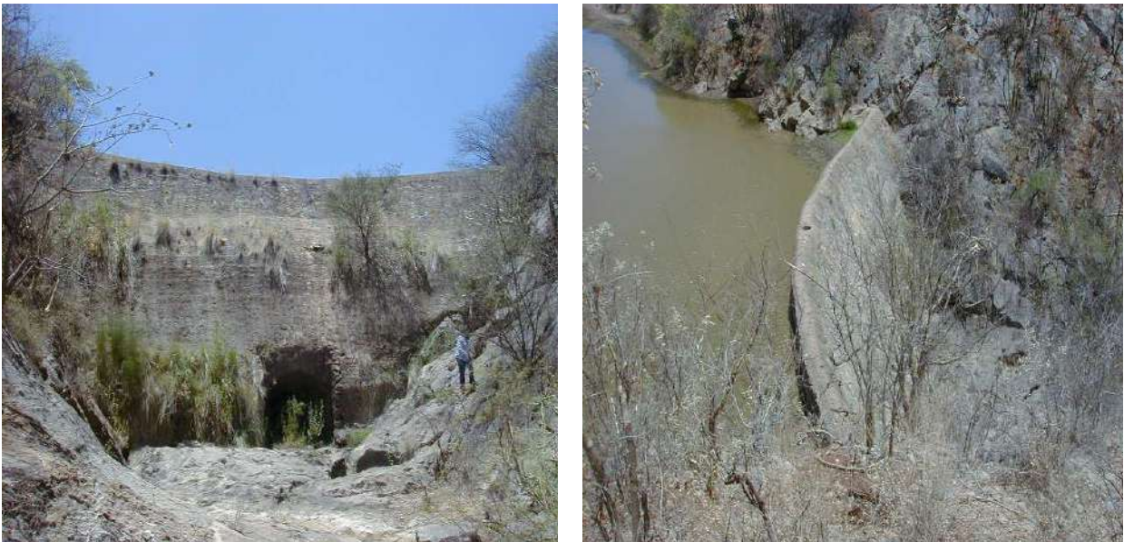
Figuras 9a y 9b.- Obra de toma y cortina del Represo El Horno
