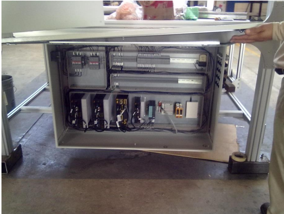
Figura 3.9 Gabinete de control.
