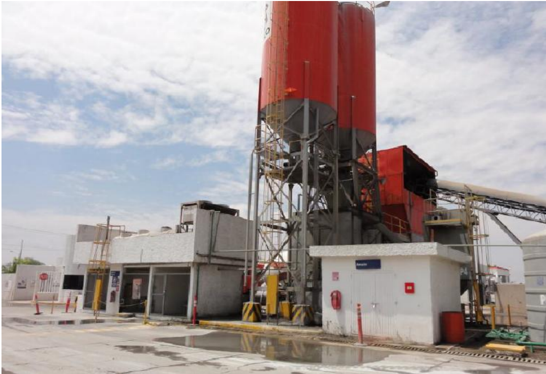
Fotografía 3.- Silos y Tolva primaria (vista lateral).
