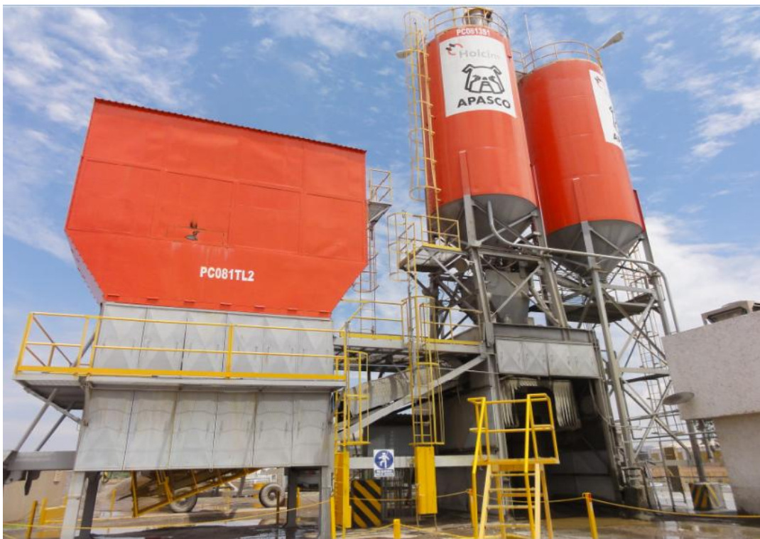
Fotografía 2.- Silos de almacenaje de cemento (derecha), Tolva primaria (izquierda).
